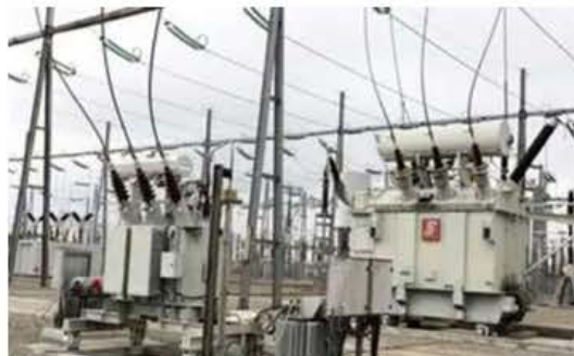
FIGURE 4.5 – Poste électrique (on trouve ce genre d'infrastructure aux bornes des villes).
