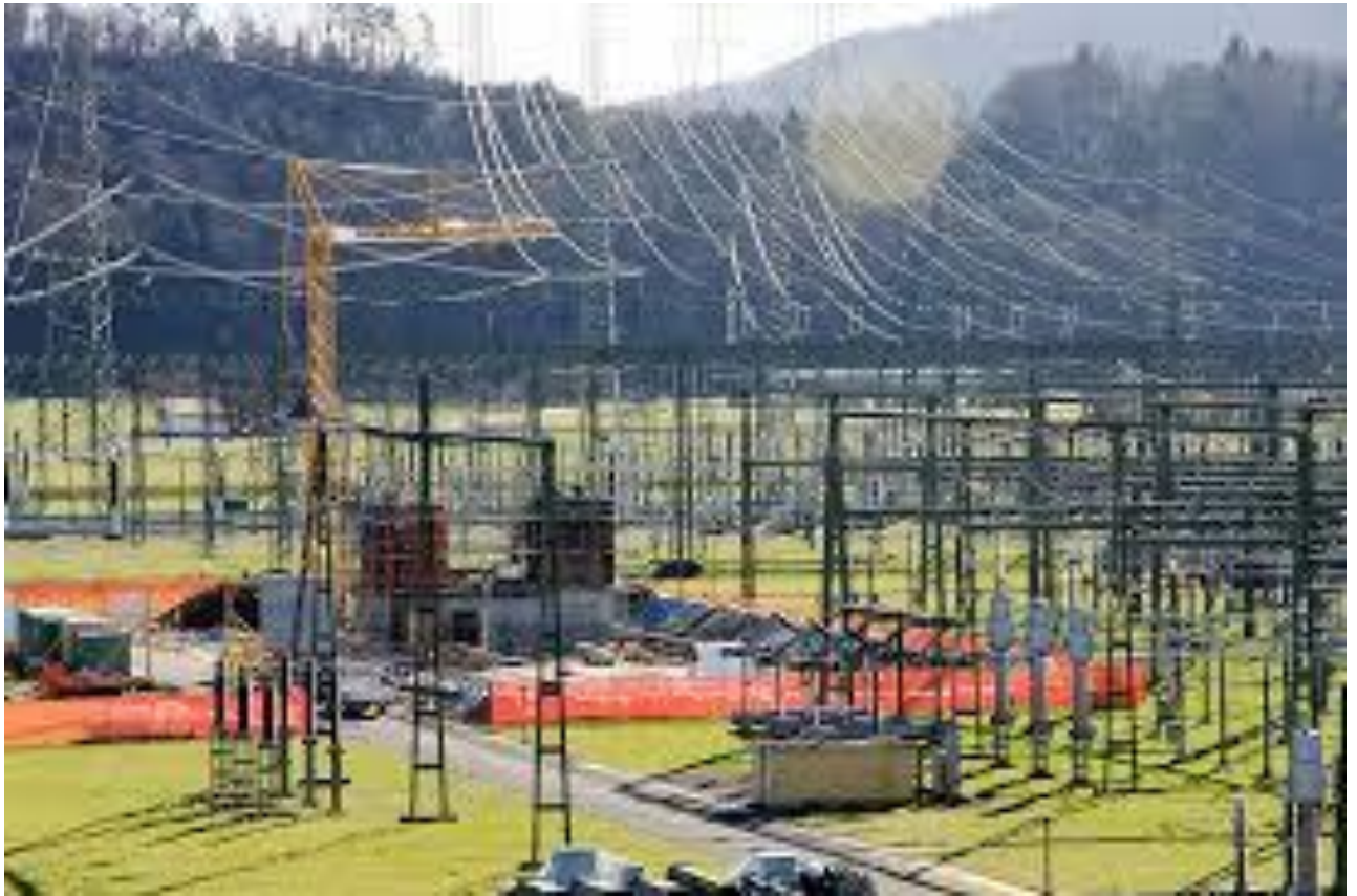
Figure 2.a. Vue générale d'un poste aérien.
