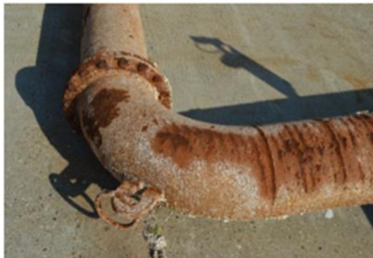
Corrosion humide pour une canalisation ayant séjourné en milieu marin
