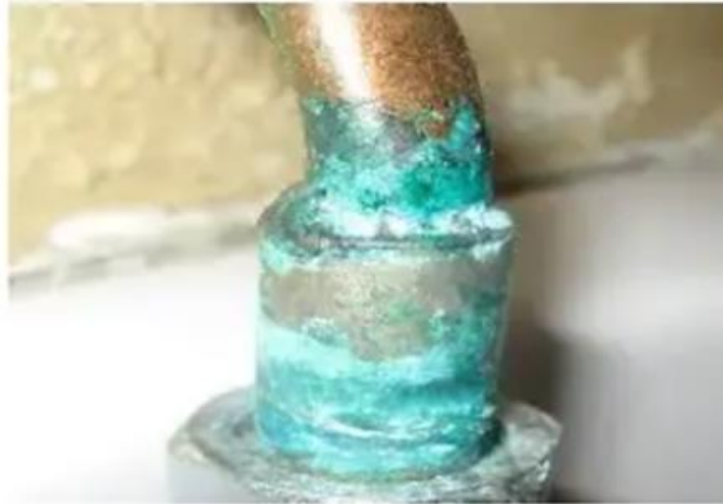
Corrosion sèche du cuivre
