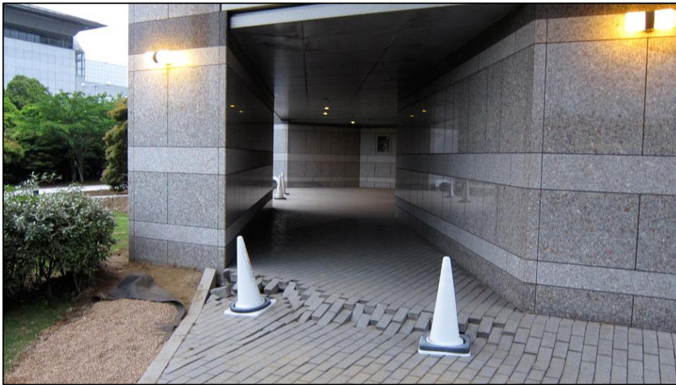
Effets de la liquéfaction dans des terrains gagnés sur la mer dans la baie de Tokyo (Chiba) lors du séisme de Tohoku (2011, Japon). En haut, exemple d'éjectas de sable. En bas, le sol s'est affaissé et déformé autour de nombreux bâtiments, nécessitant des réparations sur de grandes surfaces (photos S. Hok).
