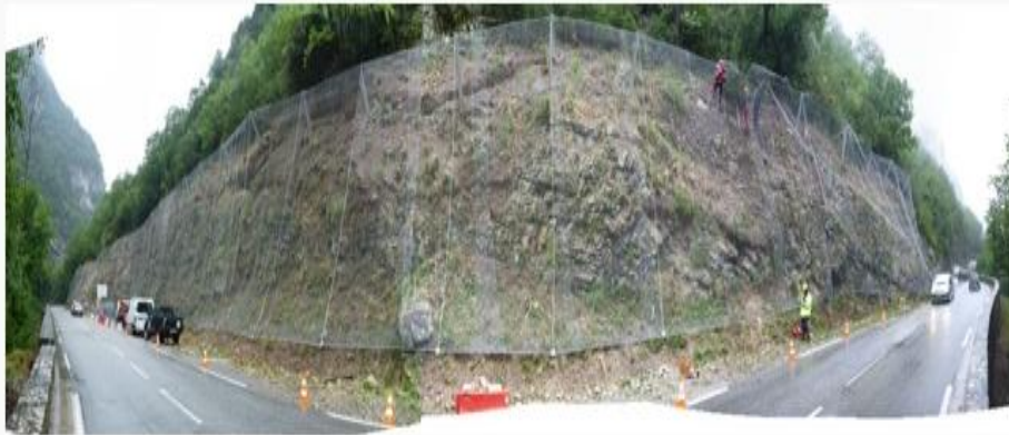
GRILLAGE PENDU SUR POTEAUX-RD 14
