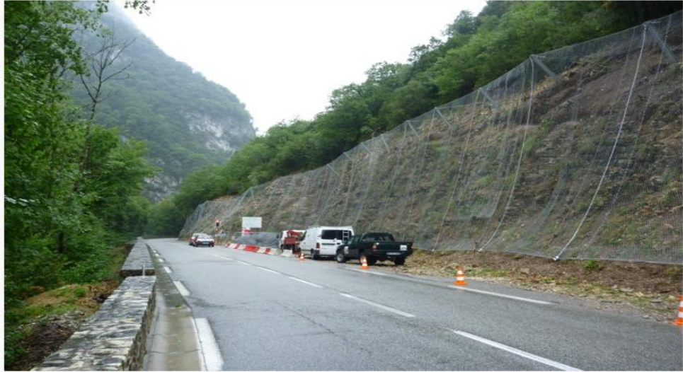
GRILLAGE PENDU SUR POTEAUX-RD 14
